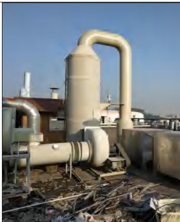
“碱液喷淋+除雾装置+二级活性炭吸附”废气处理装置
